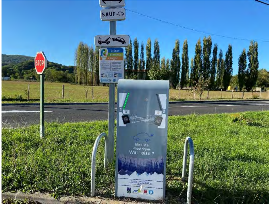
Photo 140 : Borne de recharge électrique à Sarp Image : Citadia Conseil
